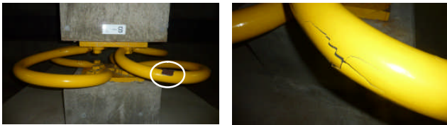
写真4 鋼棒ダンパーの塗装の剥がれ
