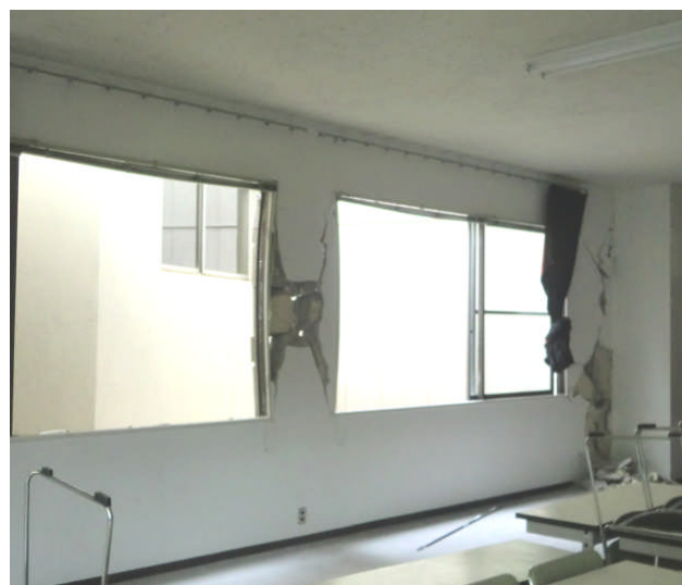
写真5 新耐震後建設建物の被害状況
