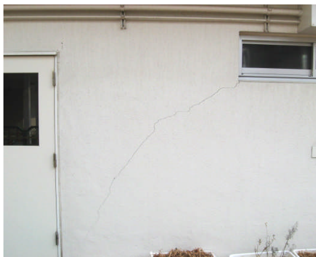
写真4 非構造壁のひび割れ状況
