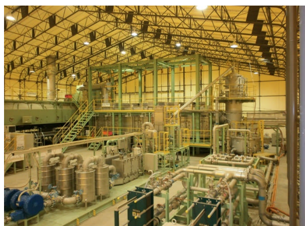
写真7 無害化処理建屋内
