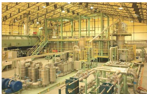
写真5 無害化処理建屋内
