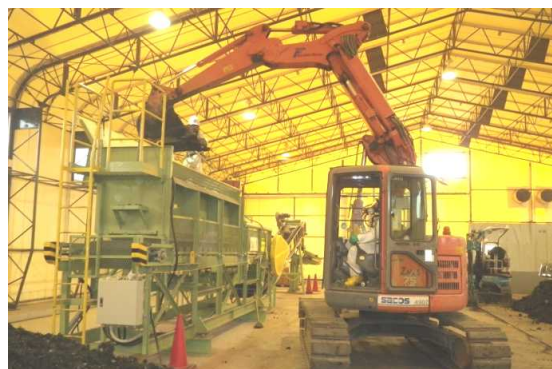
写真4 定量供給装置への投入状況
