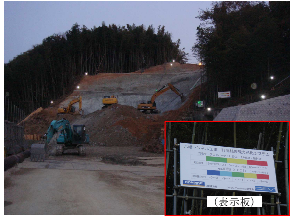
写真1 計測器設置状況
