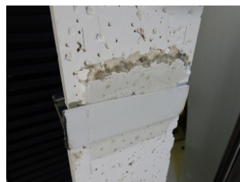
写真7 破断状況(引張試験)
