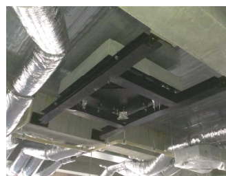
写真7 TMD設置状況
