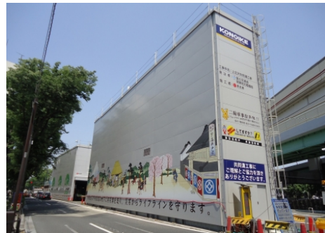
写真1 防音ハウス設置状況(2階建て)
