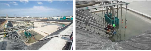
写真15 雨水沈砂池と採水状況
