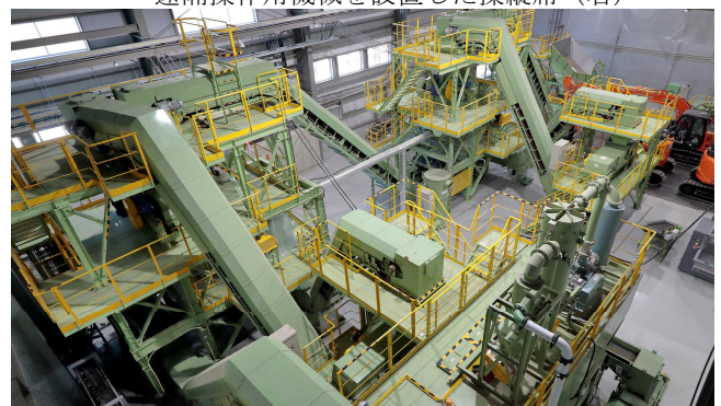
写真4 粒度調整・異物除去設備
