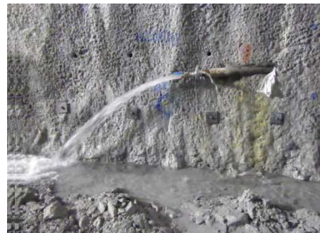
写真 4 No. 7 ボーリング孔湧水状況
