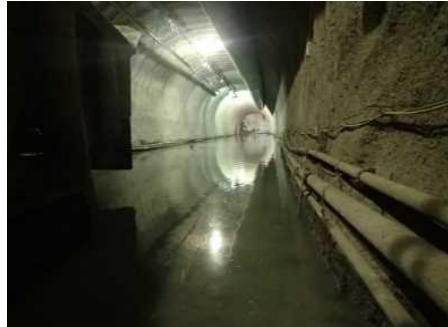
写真6 急増した湧水による水没状況 (TD. 3760m 付近)
