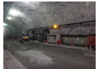
写真 16 中間ブースター設備
