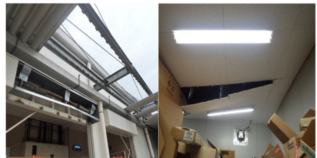
(a) 庇の被害事例 (b) 室内の被害事例
