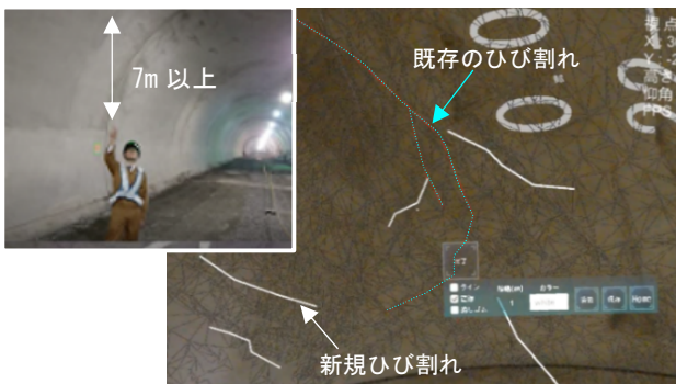
図 15 ひび割れ作図状況 (トンネル天端部)
