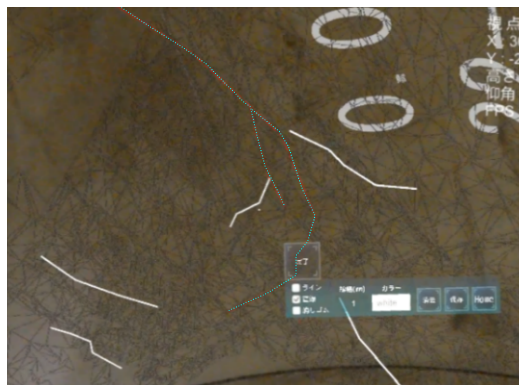
図 8 ひび割れ朱書き機能表示例
