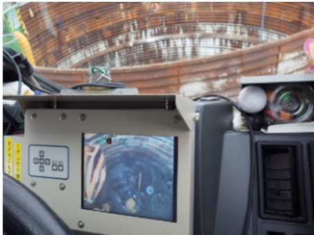
写真12 クレーンカメラ(運転席モニター)
