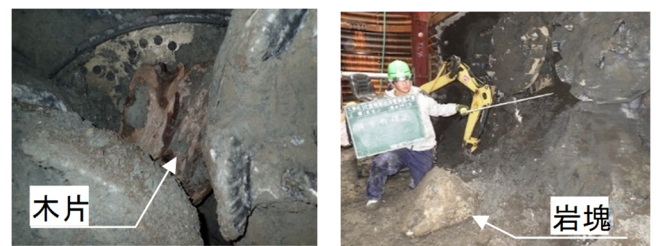
写真6 チャンパー内の木片(左)とカッターに挟まり落下した岩塊(右)
