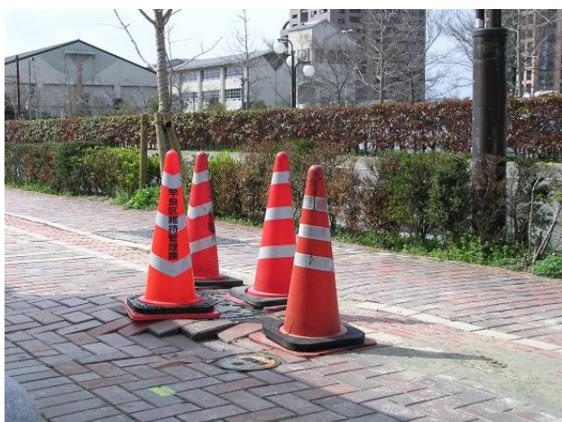
写真 10 歩道部でのマンホールの浮き上がり (噴砂が確認されたことから液状化に起因する浮き上がりと考えられる。地盤改良域近傍の未改良域で確認。)
