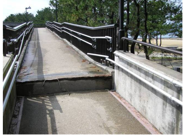
写真 11 歩道橋に生じた段差 (未改良域に位置する基礎部およびその付近で噴砂を確認したことから、液状化に起因する段差であると考えられる。)
