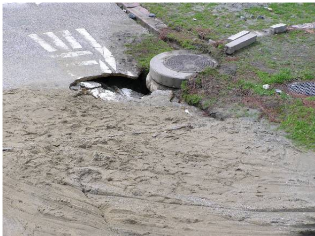
写真 9 側道で確認された噴砂と陥没
