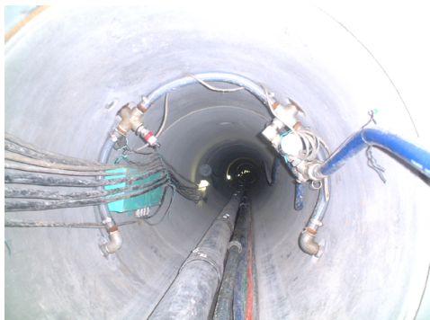
写真5 T.B.Kシステム坑内設備
