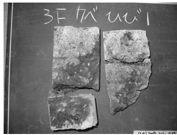
写真1 ひび割れ位置の中性化 ※淡色領域が中性化範囲
