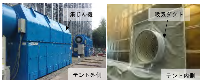
写真5 集じん機設置状況
