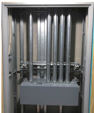
写真2 金属配管による電磁遮蔽
