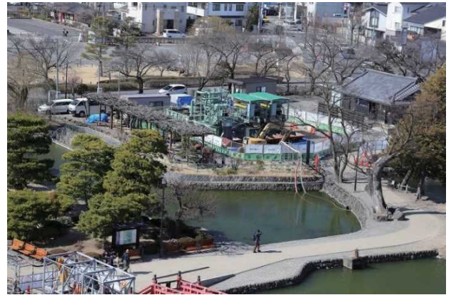
写真6 脱水固化処理設備
