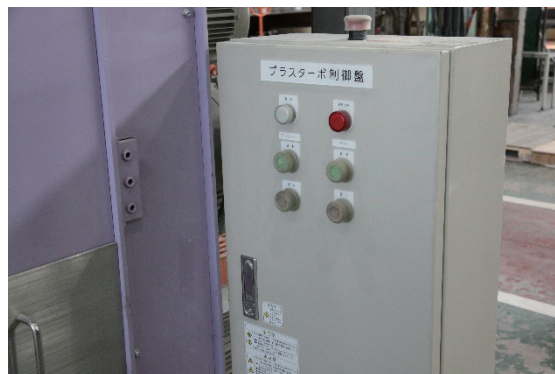
写真14 HI プラスターボード制御盤
