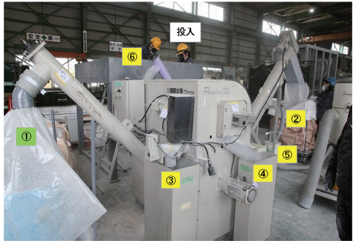
写真6 設備全景と分離物回収部
