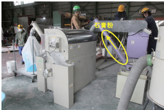
写真9 石膏粉タワー (スクリュウコンベア)
