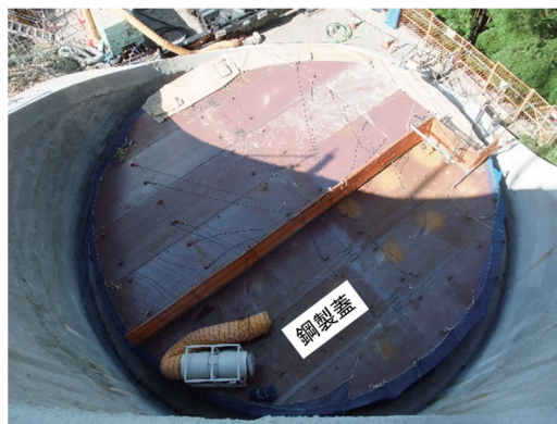
写真3 鋼製蓋による防護
