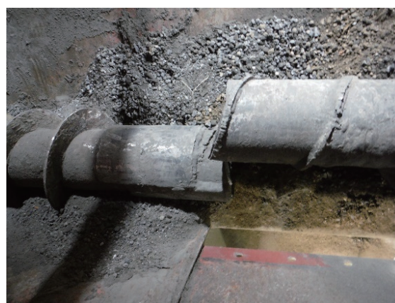
写真6 スクリューコンベアの破断状況
