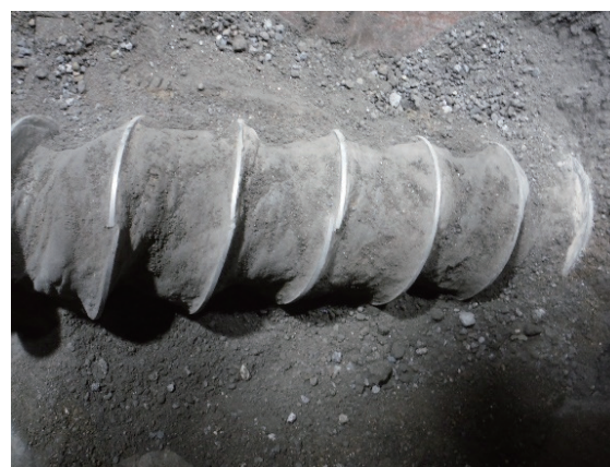
写真5 スクリューコンベアへの処理対象物付着状況
