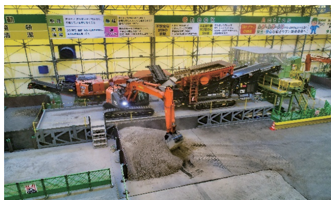
写真8 硬化灰の破碎設備
