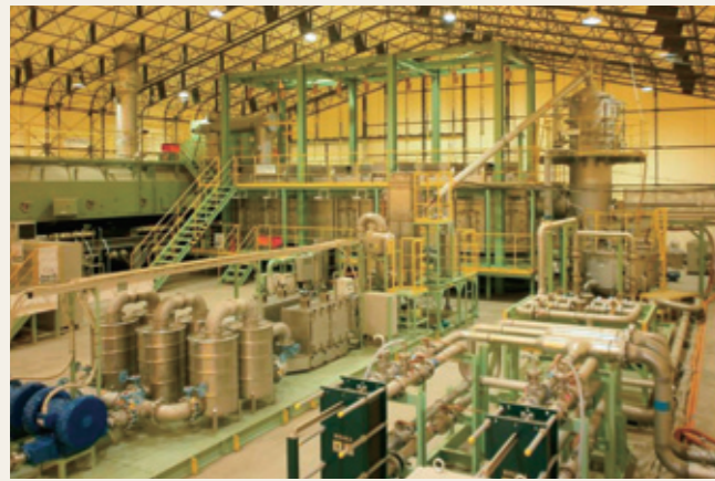
テント内に設置された無害化処理施設
