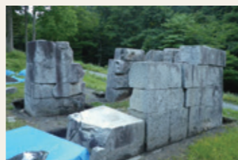
修復着手前(積石の落下やズレ・割れがある)
