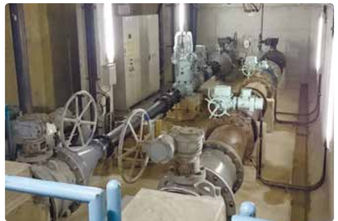
地下部:配管室
