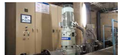
東灘第1低層配水場小水力発電事業現地風景
